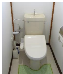
水洗&温水洗浄便座完備
