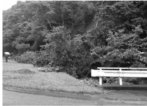
静内春立地区被害状況
