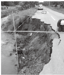
神森田原線の被災状況
