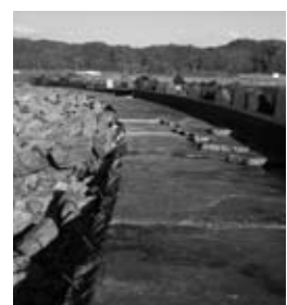
東突堤破損箇所
