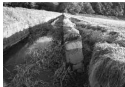
護岸傾斜・欠損被害を受けた寺沢川
