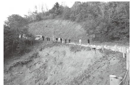
三石・林道ボンルベシベ線崩落現場
