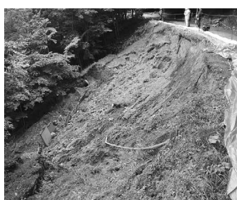
春別農屋線災害現場
