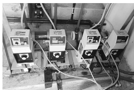
被災した塩素滅菌装置
