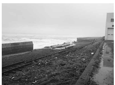
被災した線路（駒場）
