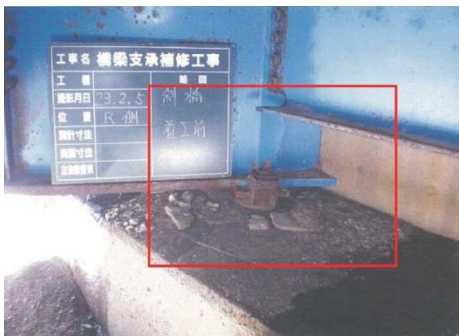
通常点検にて支承の損傷確認
