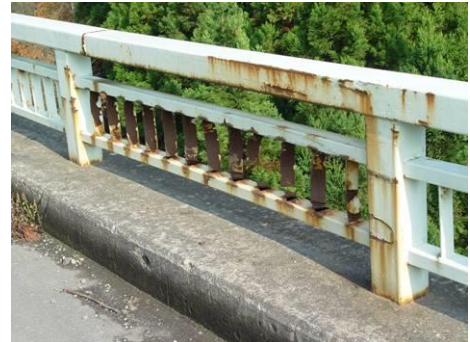
写真1 高欄部材の欠損
