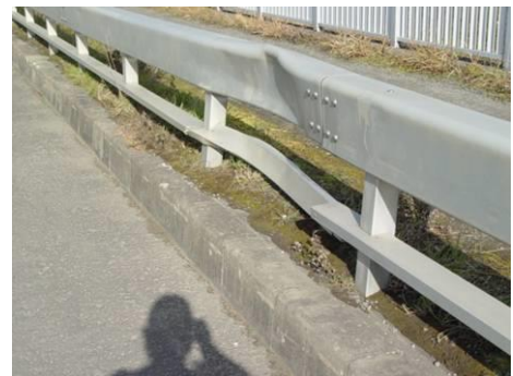
写真2 防護柵の著しい変形
